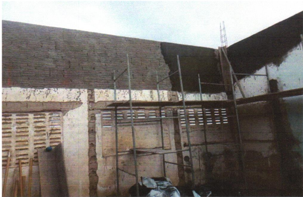
FOTO 11 – CHAPISCO APLICADO EM ALVENARIA (COM PRESENÇA DE VÃOS) E ESTRUTURAS DE CONCRETO DE FACHADA, COM EQUIPAMENTO DE PROJEÇÃO. ARGAMASSA TRAÇO 1:3 COM PREPARO EM BETONEIRA 400 L. AF_06/2014
