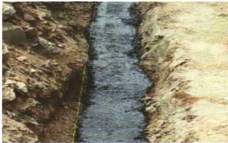
FOTO 05 – LASTRO DE CONCRETO MAGRO, APLICADO EM BLOCOS DE COROAMENTO OU SAPATAS, ESPESSURA DE 3 CM. AF_08/2017
